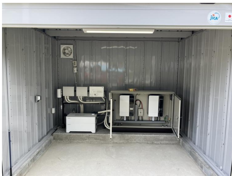
パラオ・ペリリュー州 政府庁舎の格納庫内に設置された Growatt「AXE 5.0L Modular Battery」（パネル容量：5.9kW） ハイブリッド 3 kW PCS×2 台／蓄電ユニット 5 kWh×2 台
